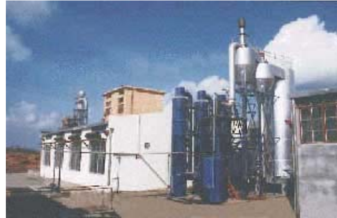
海南省三亜木材工場の1000KWの木材くずガス化発電所
